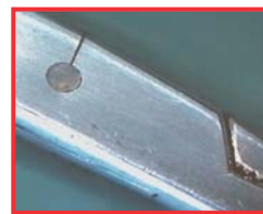
Povrchová trhlinka v nýtu kloubu
