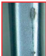
Detail elektrolytické koroze
