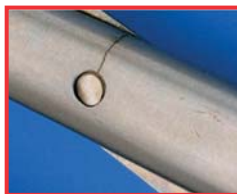
Povrchová trhlinka v závitu spojení
