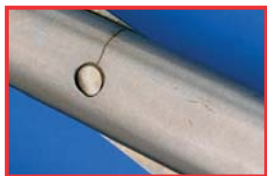
Vlasová trhlina v oblasti kloubu nůžek
